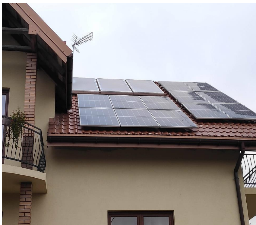
Instalacje kolektorów słonecznych oraz fotowoltaiczne
