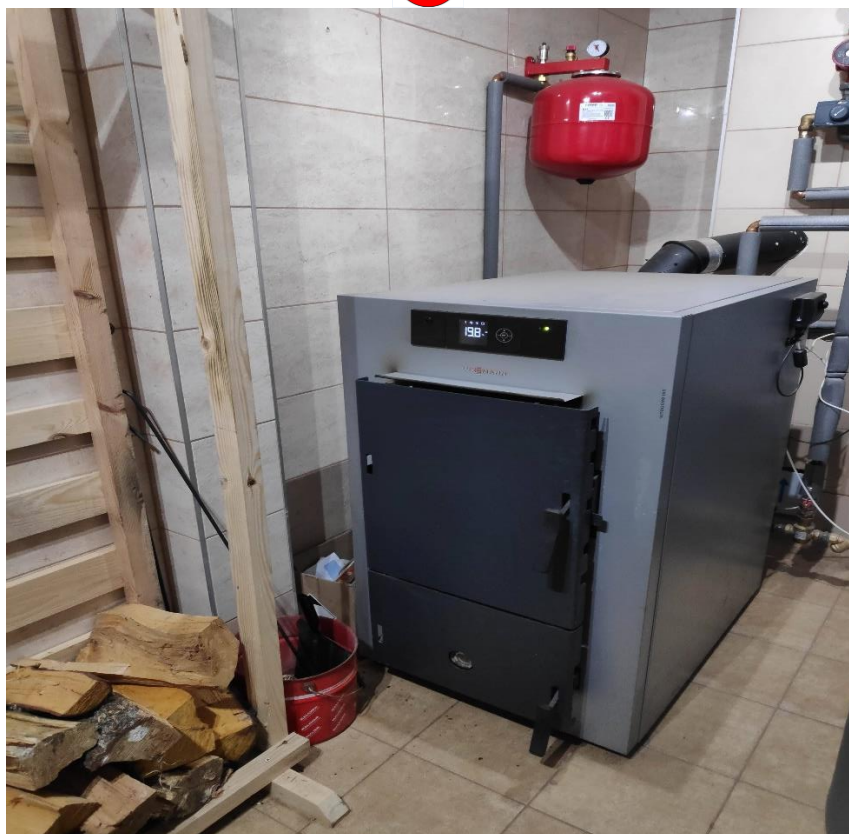
Kocioł zgazowujący drewno
